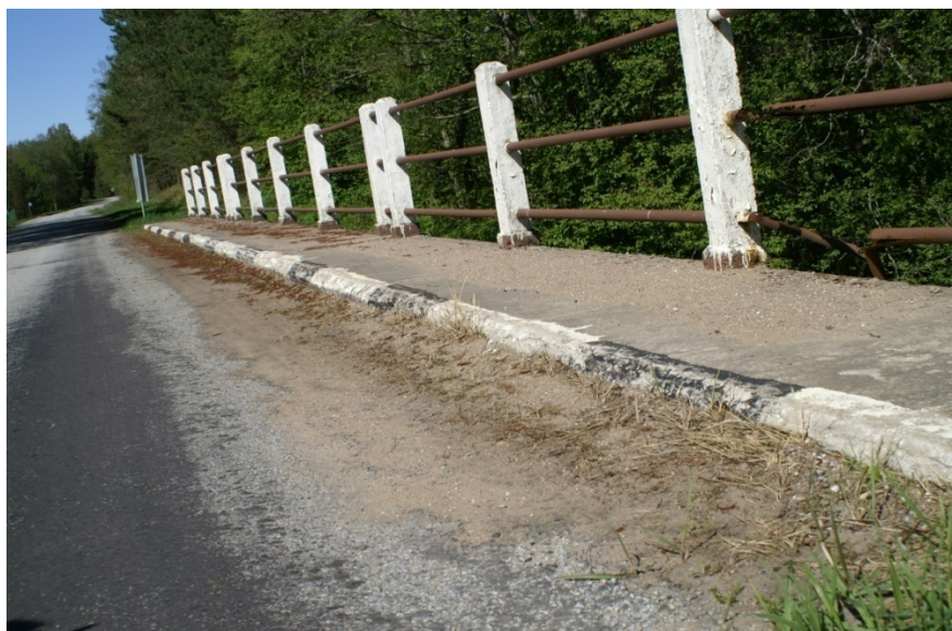
Foto 6. 18. mai ülevaatusel tehtud pilt sillast kõrvalteel, kus talvel kogunenud sool ja praht on koristamata ning sillapiirded läbi roostetanud.
