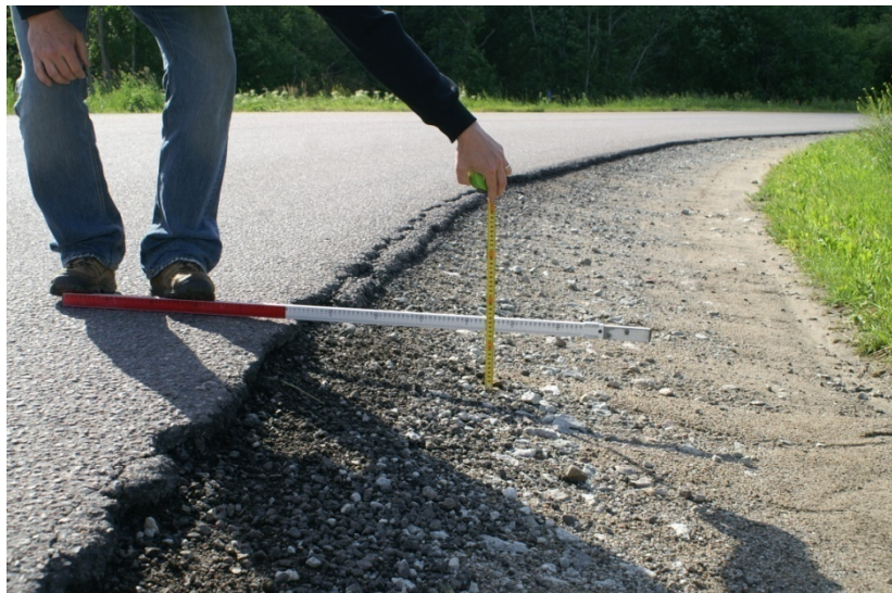
Foto 3. Esmapilgul ideaalses korras teel on tegelikult lubamatult madal teepeenar (maksimaalne lubatud kõrguse erinevus kuni 5 cm), mis põhjustab teekatte serva lagunemist ja on liiklusohutuse seisukohast sellises kurvis väga ohtlik.
