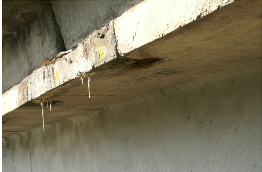
Foto 8. Vee toimel betoonist välja ladestunud sooladest stalaktiit näitab, et silla kapitaalne remont on peagi vältimatu.
