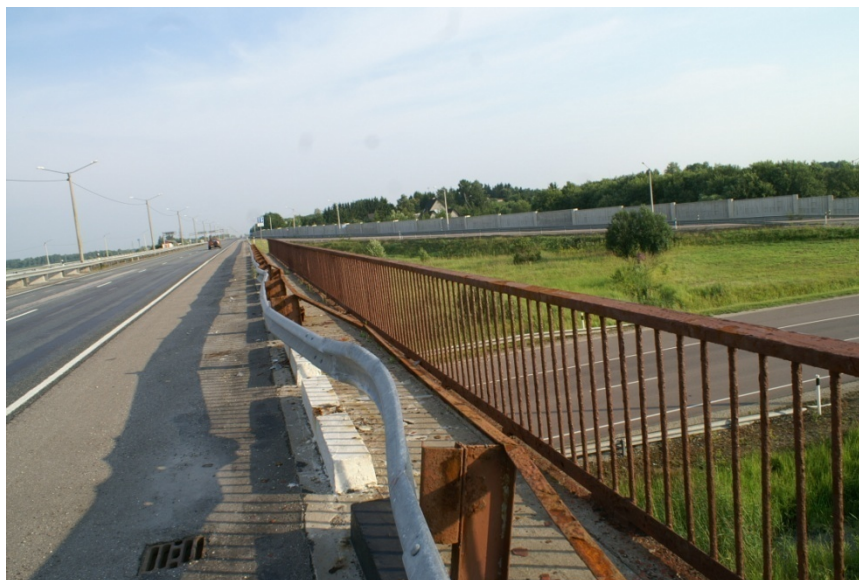
Foto 10. Kui sellisele kahjustatud postide ja tõmbelattidega piirdele peaks otsa sõitma auto, siis suure tõenäosusega lõpeks avarii läbi piirete sillalt allasõiduga.
